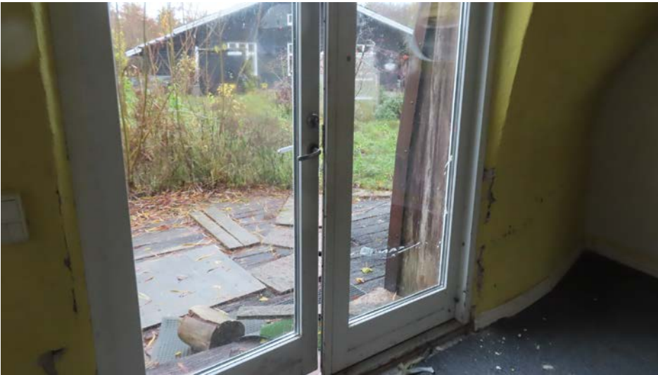
Terrassedøren kan ikke lukkes grundet skævhed og termoruden er knust.
