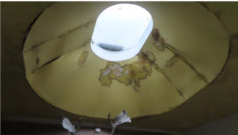
Utætheder i taget har ødelagt loftsbeklædningen
