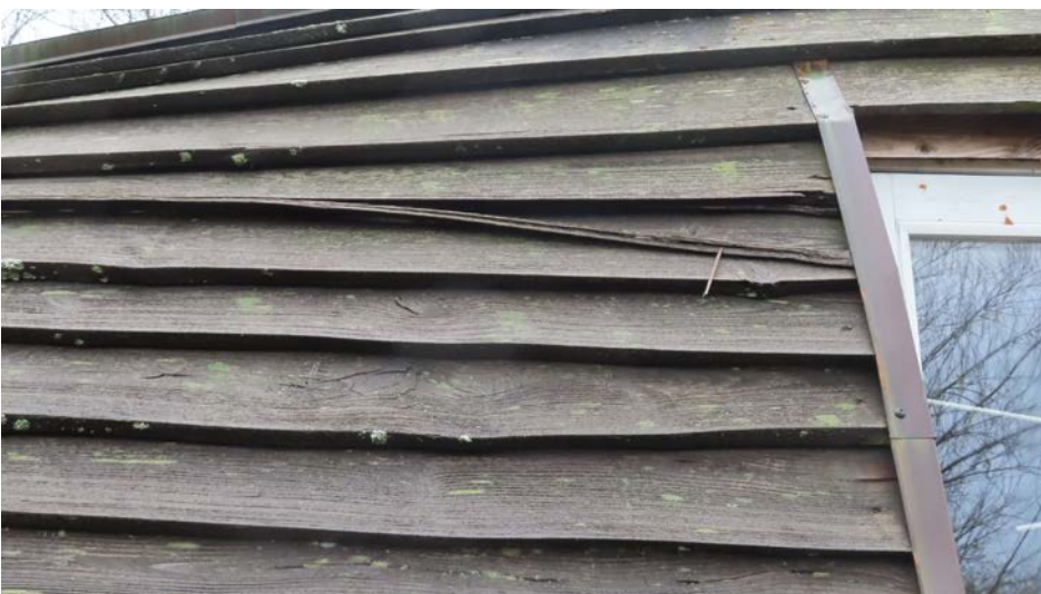
Beklædning er generelt under kraftig nedbrydning.
