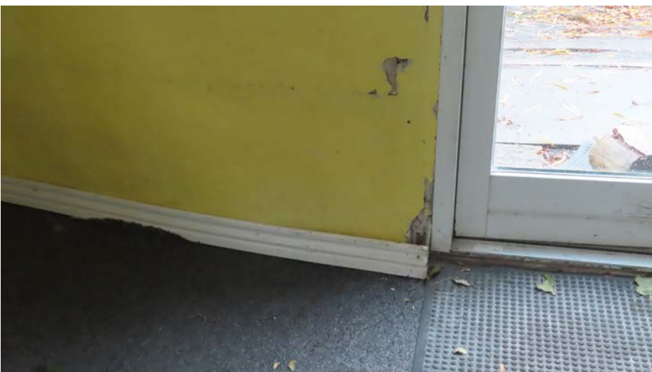
Afskalninger af puds indikerer fugt i væggen.
